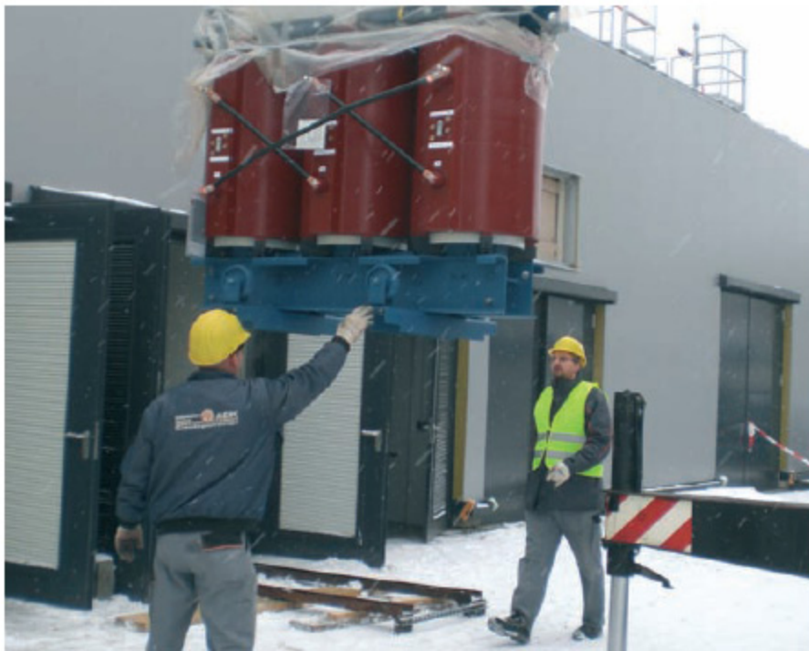
Michael Haferkorn und Olaf Kästner bei der Einbringung eines 1600 kVa-MS-Transformators in der Solar Factory III in Freiberg.
