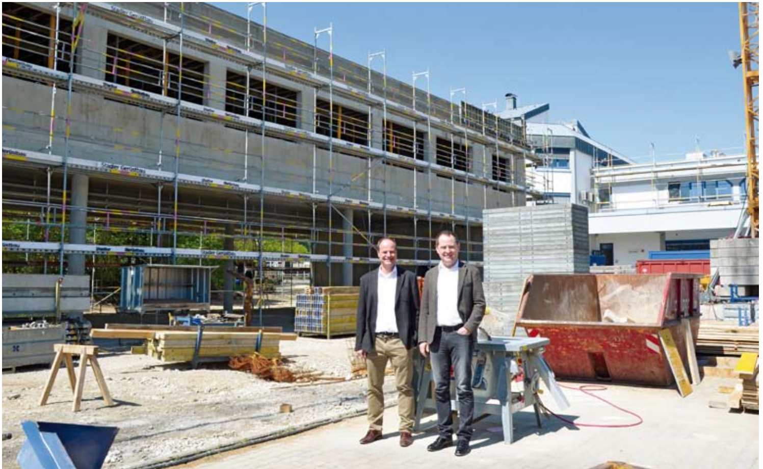
Fritz Kreuzpointner (li.) und Florian Schneider an der Baustelle in Burghausen, wo bis Jahresende rund vier Millionen Euro in die Erweiterung unserer Unternehmenszentrale investiert werden.
