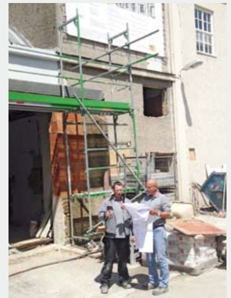
Obermonteur Bernd Hierl (li.) und Bauleiter Lars Vaupel an der Baustelle, einer ehemaligen Kammgarnspinnerei.
