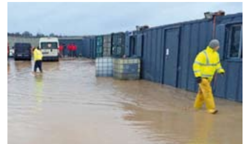
Land unter bei der Baustelleneinrichtung.
