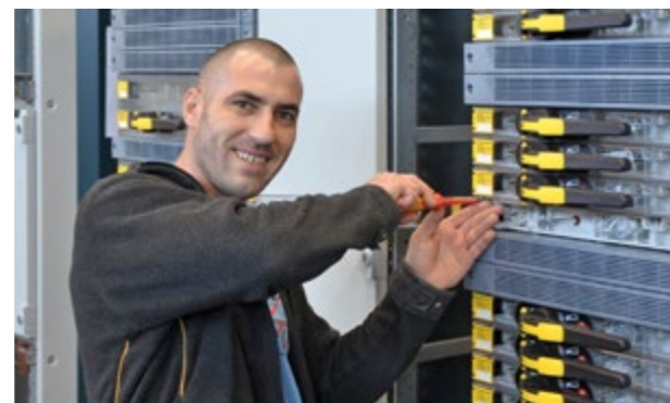
Istvan Boros schraubt eifrig an einem NSHV-Schrank, der noch im Dezember 2018 in das norwegische Wacker-Siliciumwerk Holla geliefert werden muss.
