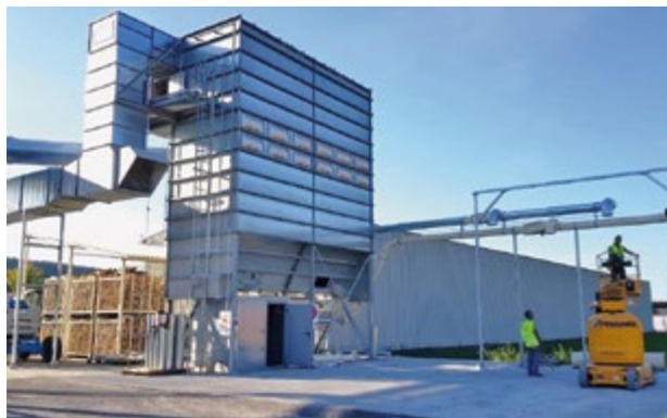
In Ungarn wurde das Heraklit-Werk von Knauf erweitert und dabei von der AER elektrotechnisch betreut.
