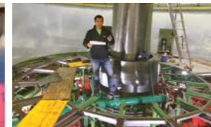
Bauleiter Josef Rothenbuchner auf einem der 225 Tonnen schweren Generatorrotoren.
