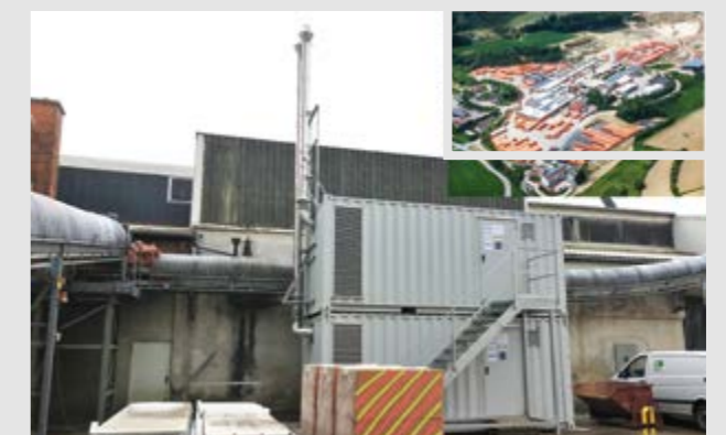
Die beiden von Kreuzpointner installierten Notstromanlagen für das Zeilerner Ziegelwerk (kleines Bild).
