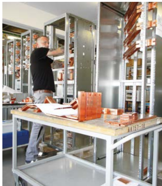
NOVALED-Baustelle Dresden: Die örtliche AEK-Bauleitung (kleines Bild re.) und unser SAB-Fachbauleiter (von links) Obermonteur Felix Hauff, Torsten Friedrich, Patrick Fleischer (Schaltanlagenbau) und Bauleiter Ingo Waldeck. Kleines Bild links: Schaltanlagen-Werkstatt-Leiter Henry Hempel.
