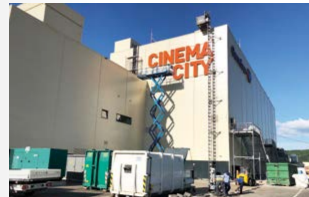
„Dauerbrenner“ Cinema City: Ein weiteres 3-D-Kino wurde elektrotechnisch ausgestattet.
